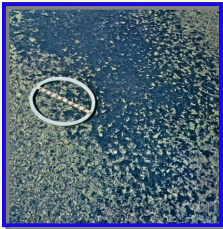
DETALHE DA EXSUDAÇÃO
