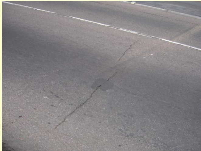
Deficiência na execução da junta transversal
